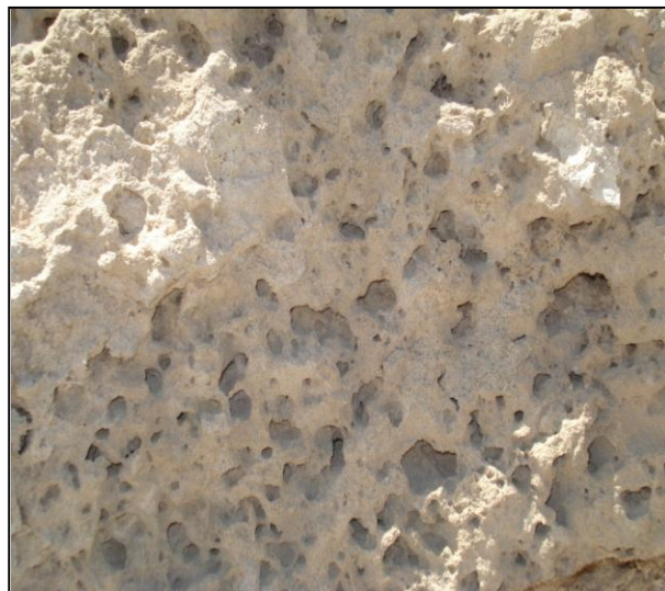
شكل (15) يوضح أثر التجوية الشبيه بخلايا النحل على مواد بناء لبعض المباني بالمدينة القديمة (تصوير الباحث).
