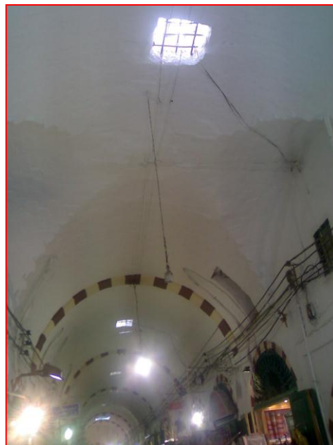
صورة (11/أ) توضح الفتحات التي بسقف سوق الرباع بالمدينة القديمة طرابلس الغرب.
